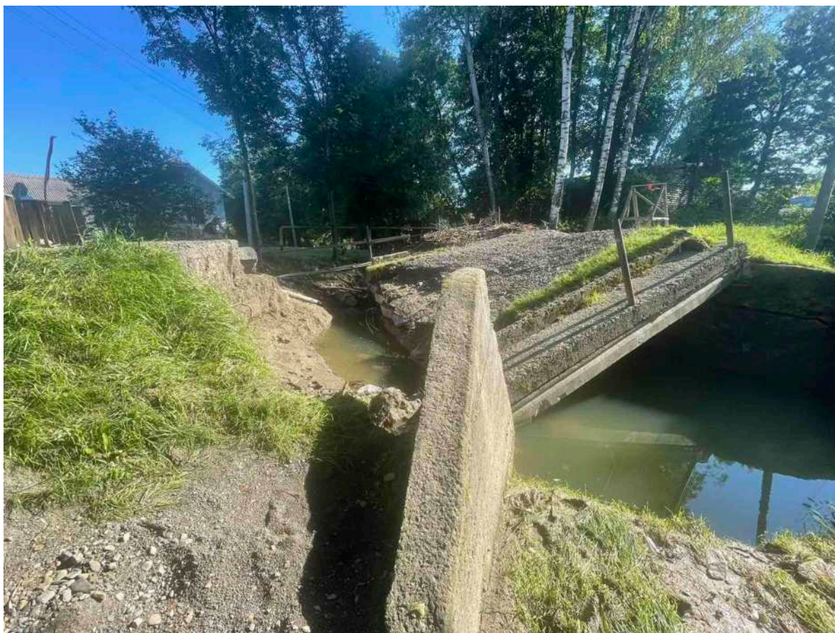
Зруйнований міст після повені 07.07.2023р. у с.Великий Ключів
